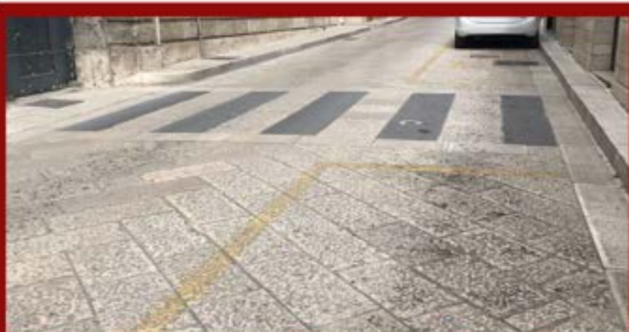
Attraversamento pedonale realizzato con pietra Serena nella pavimentazione stradale di basole di Trani
