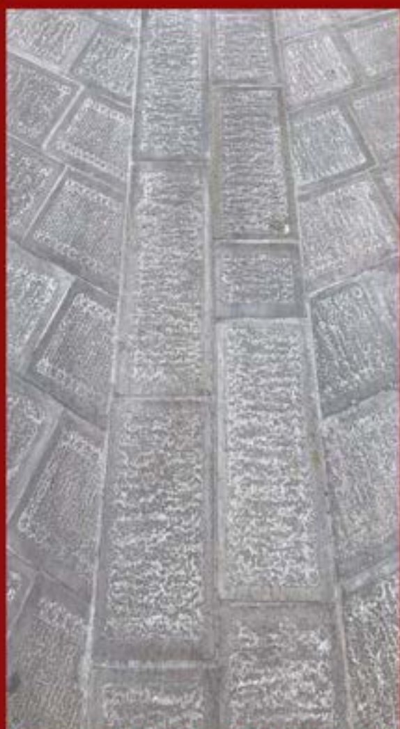
Pavimento a basole squadrate posato a spina di pesce con deflusso centrale
