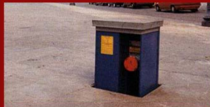
Colonnina di distribuzione elettrica a scomparsa nel pavimento
