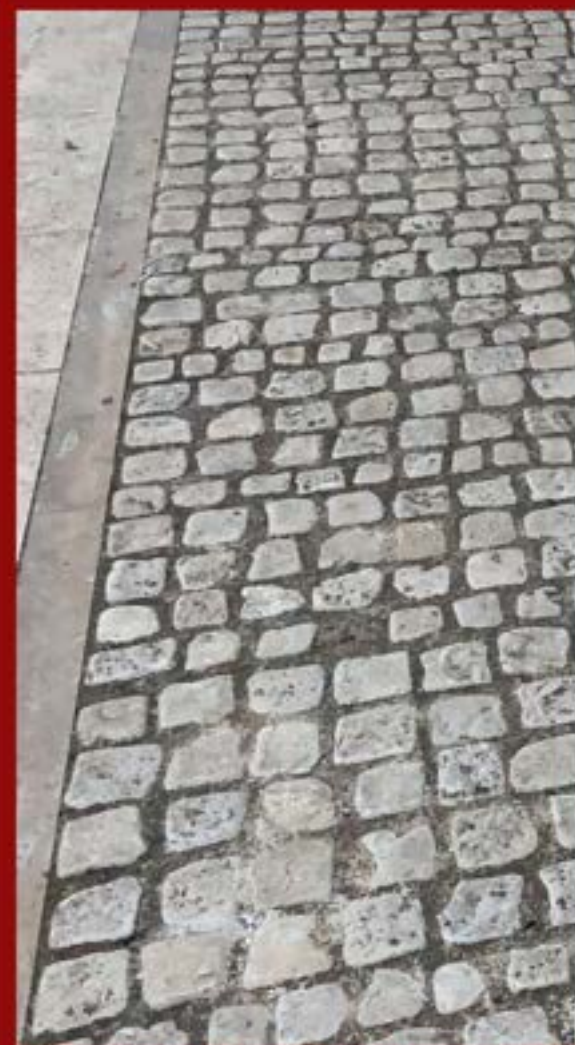
Pavimento a cubetti in pietra posati a correre con cordolo in pietra di Trani
