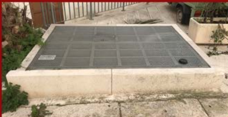
Cabina di servizio Enel interrata con griglia calpestabile
