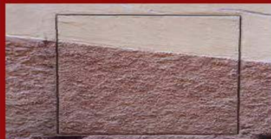
Cassetta per contatori, incassata a muro e intonacata
