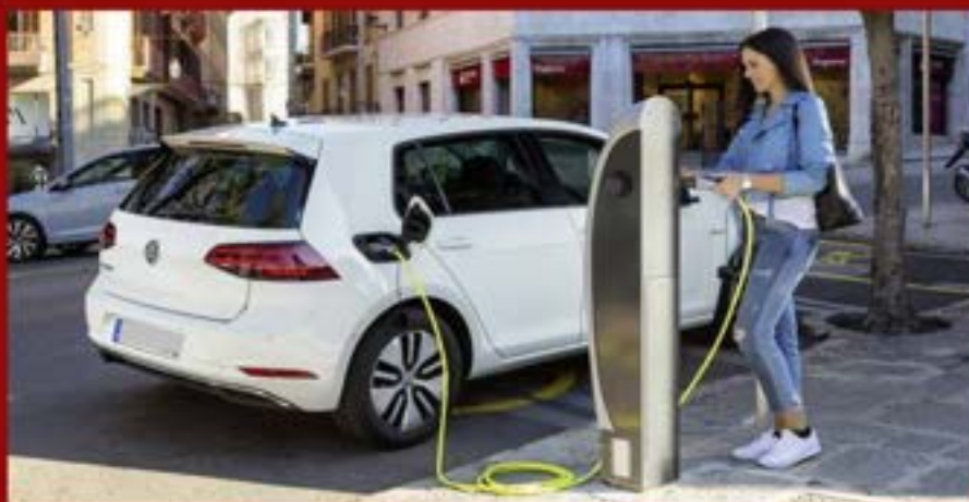
Colonnina di ricarica auto elettriche
